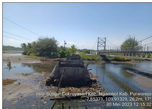
Gambar 7. Jembatan Runtuh Akibat Banjir
