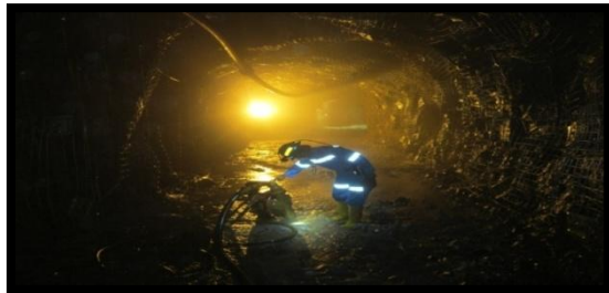
Gambar. Wilden pump sedang beroperasi di 1116 Cibitung
