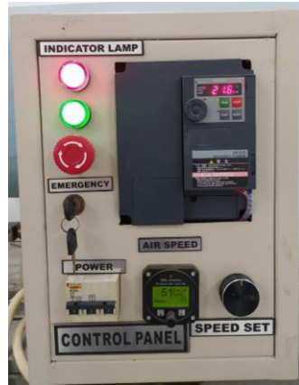
Gambar 8. Indikator monitor pada wind tunnel
