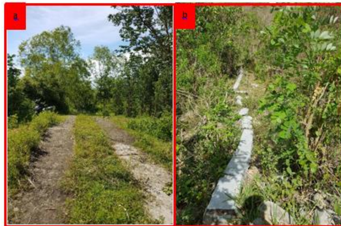
Gambar 14. Kondisi jalan yang masih baik, Gambar 15. Kondisi jalan rusak akibat gerakan tanah (arah lensa foto menghadap timur)
