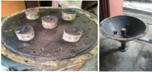
Gambar 3. Distributor dan Plenum Instalasi tersebut terdiri dari beberapa alat yaitu
