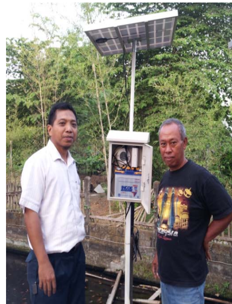
Gambar 8. Hasil Alat Peralatan Pompa air pada kolam ikan tenaga matahari
