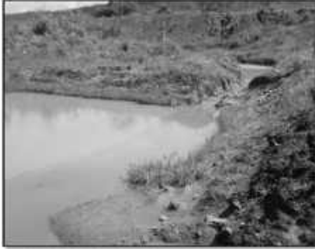
Gambar 3 Kondisi Fisik Settling Pond WCP 2
