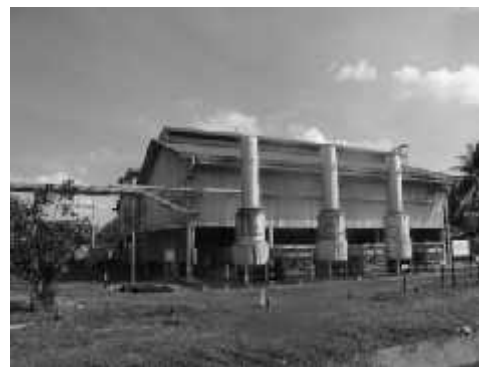
Gambar 1. Gas Turbin (Unit Pembakaran)
