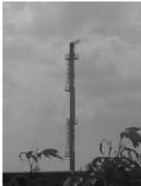
Gambar 5. Flare Stack (Unit Suar Bakar)
