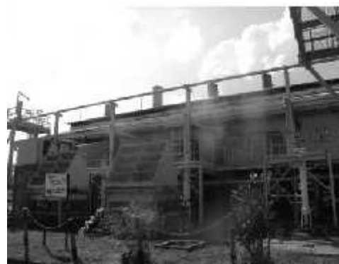
Gambar 2. Kompresor (Unit Pembakaran)
