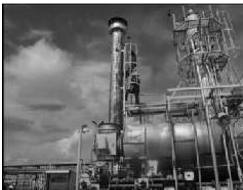
Gambar 6. Glycol Dehidrator (Unit Dehidrasi)
