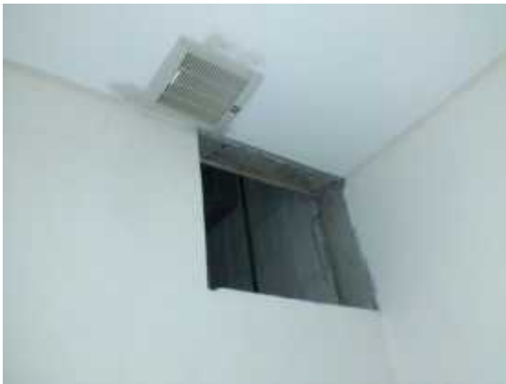
Gambar 11. Grill Inlet untuk pembuang udara berbau tidak sedap menuju shaft (cerobong)
