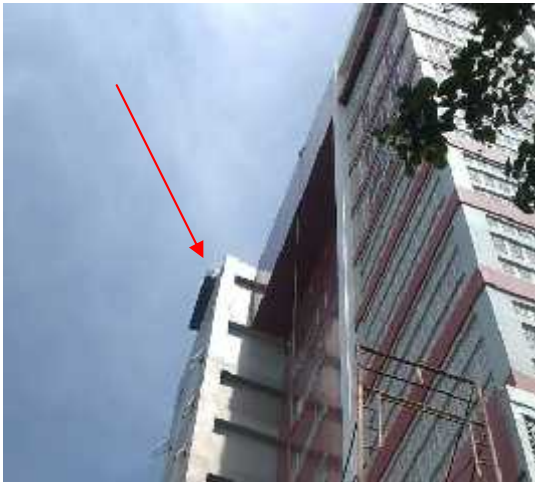
Gambar 18. Penampang Corong Cyclone yang telah terpasang di gedung At-Tauhid Tower
