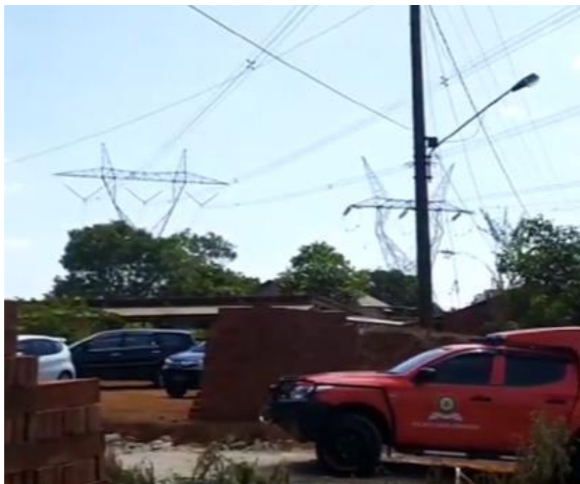
Gambar 2. Span tower 434 – 435, Konfigurasi Horizontal, dengan Tower Ganda
