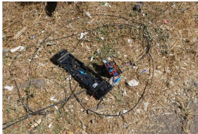
Gambar 4. Box Terminal jaringan listrik 20 kV/220 V ikut meledak
